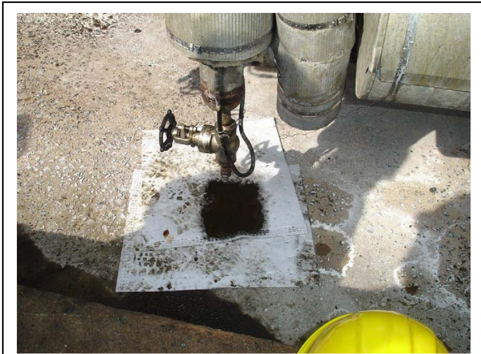
사진 4-5 E-8301 Shell측 Level Gauge의 Drain 결과(Hot Oil 누출)
